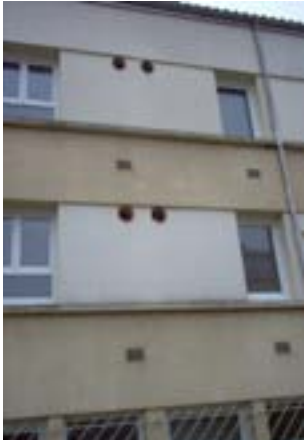
Conduit de fluide (air) gaines aération sanitaires
