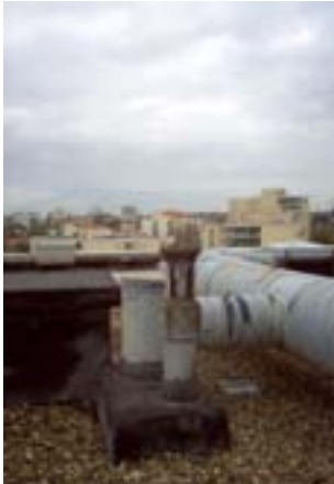
Conduit de fluide (air)
